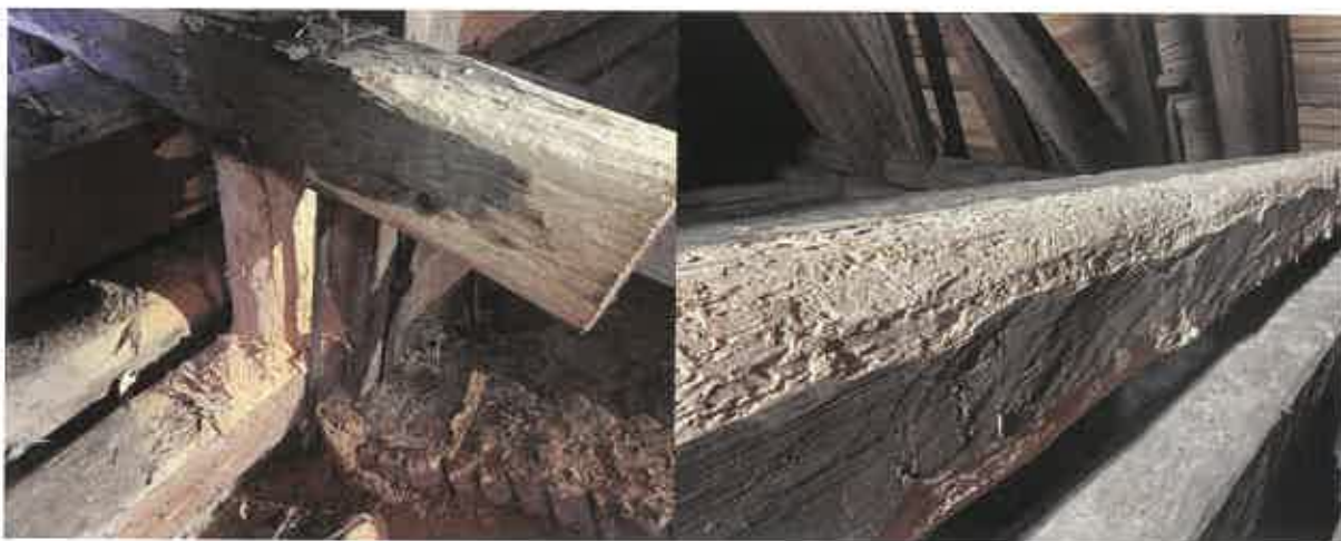
Obr. 4 - Konstrukční prvky zasažené biotickou degradací, požerové chodby tesařika krovového
