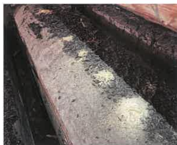
Obr. 3 - Znečištění konstrukcí vrstvou prachu a trusem netopýrů
