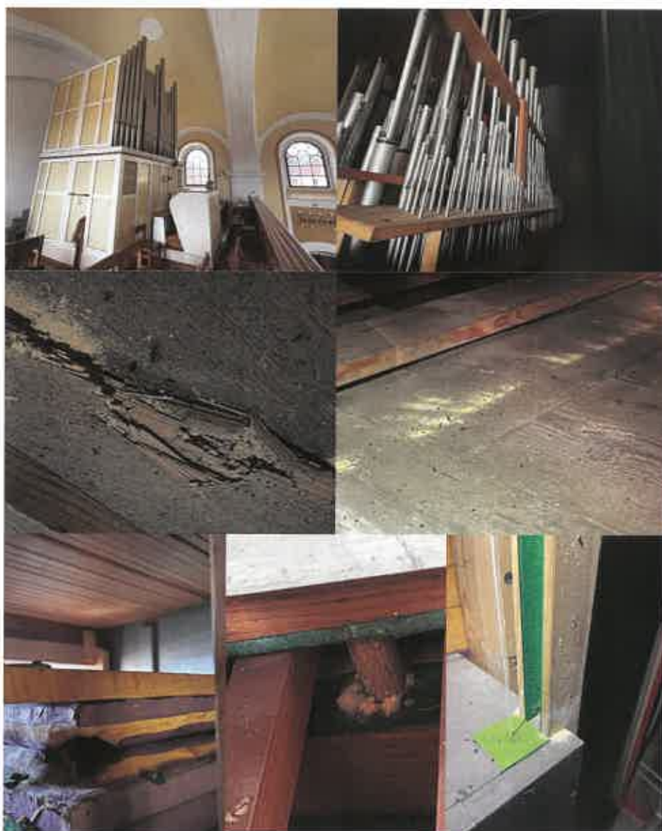
Obr. 7 - Konstrukce varhan – dřevěné prvky napadené červotočem pronikavým
